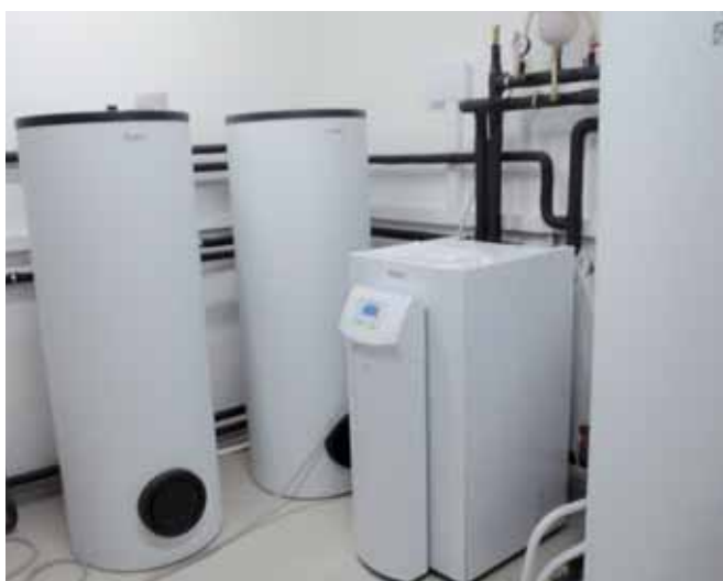
Kotlovnica u Pazigradskoj ulici: geoTHERM VWS 171/2, međuspremnik VPS 750, dva spremnika PTV VIH RW 300
