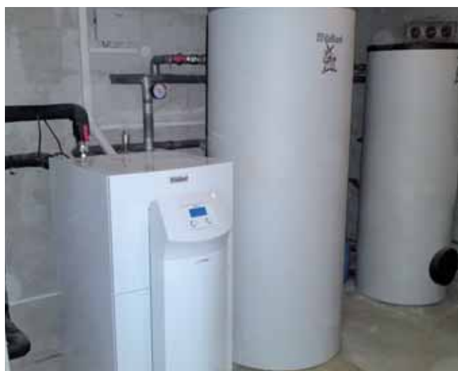
Postrojenje s dizalicom topline u Novom Vinodolskom
