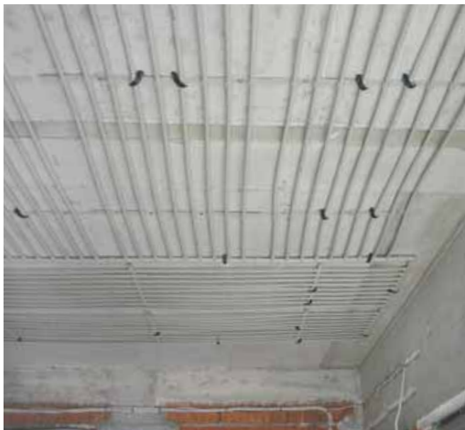
Detalj stropnog grijanja i hlađenja - Banjole, Medulin
